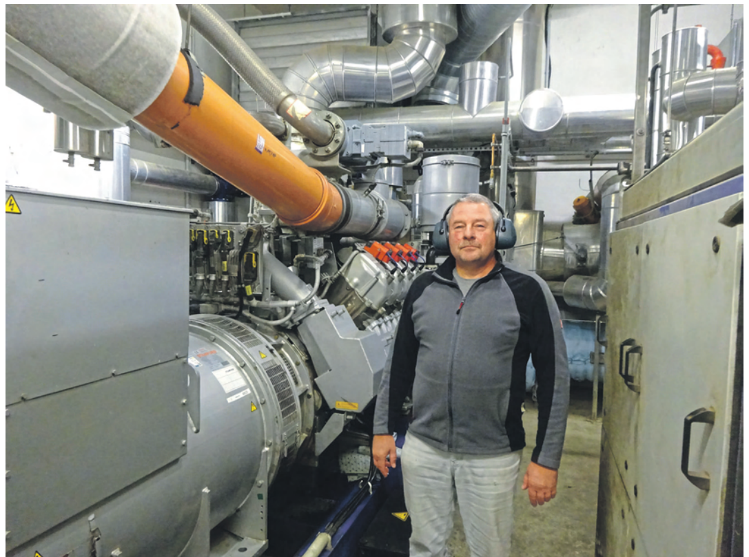
Anlagen-Leiter Sven Orłowski im Maschinenraum der Biogasanlage in Rampe: „Der Ruf des Klee gras als Substrat ist schlechter als unsere bisher 3-jährigen Erfahrungen damit.“
